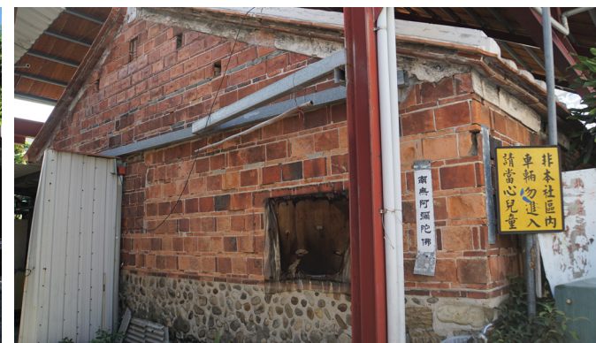
▲ 建物超過百年，有漏水及倒塌的危險
