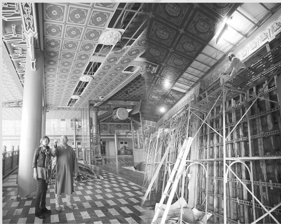
▲ 新化接天寺位於地震帶，大殿受創嚴重
