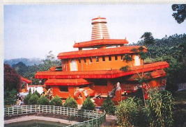
▲地藏王菩薩殿一樓倒塌，屋頂飾物折斷。
