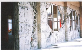
▲室外石村掉落
