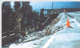
▲靈巖山寺道路邊擋土牆坍塌，造成路面陷落
