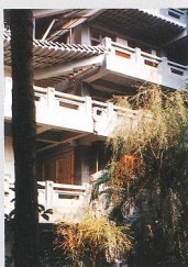
▲白雲禪寺 右側廂房前後段樓層數不同，彼此互撞接觸處見裂土受損。
