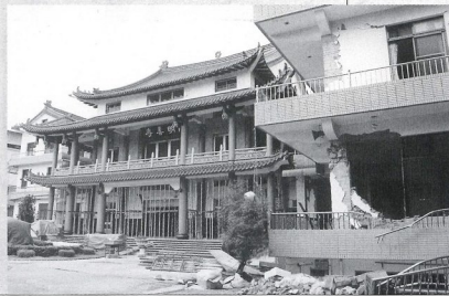
▲暫以鐵架支撐的明善寺大殿
