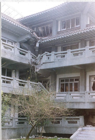
▲落差數公尺的兩棟建築物
