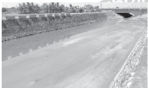
這是偷排廢酸廢水的暗管，圖中的涵洞已被污染成五顏六色，多少的污染廢水從這些暗管排放，難以數清。
