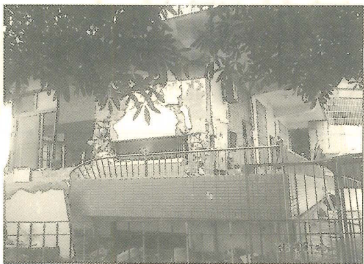
921 震後一樓側面
