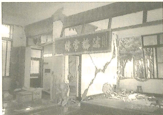
921 震後一樓內部
