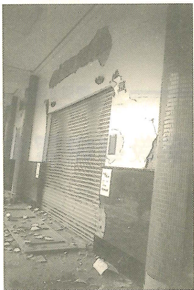
震後大殿一樓評為危樓
